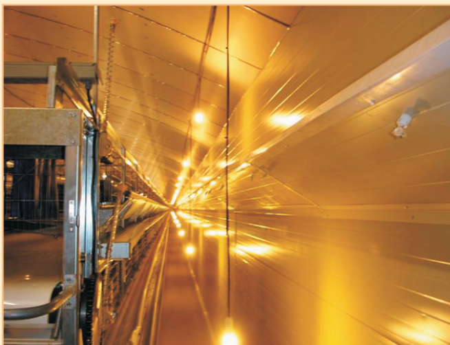
Detalle de las trampillas de las entradas laterales de aire.
