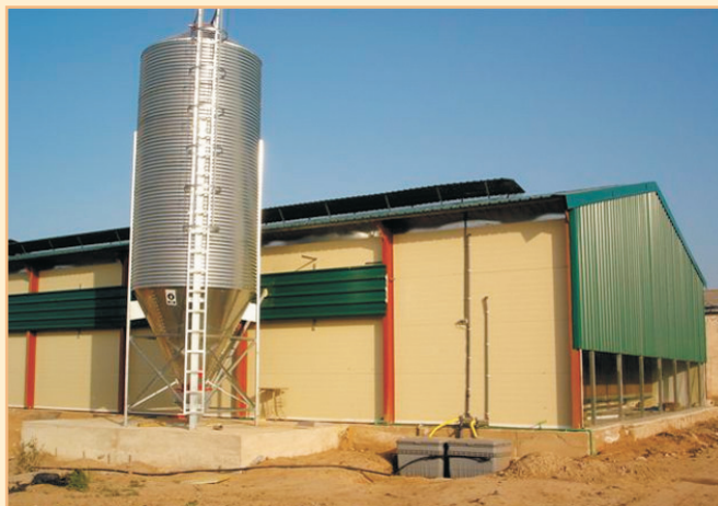
Frontal con paneles de refrigeración —"coolings"— protegidos.
