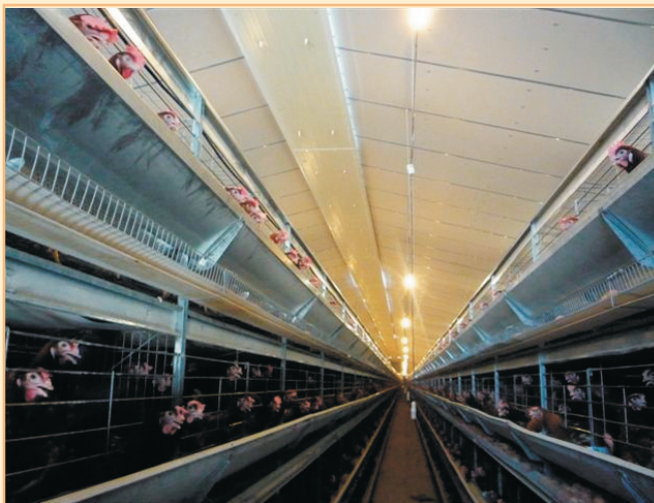
Vista interior del caballete del lucernario central.
